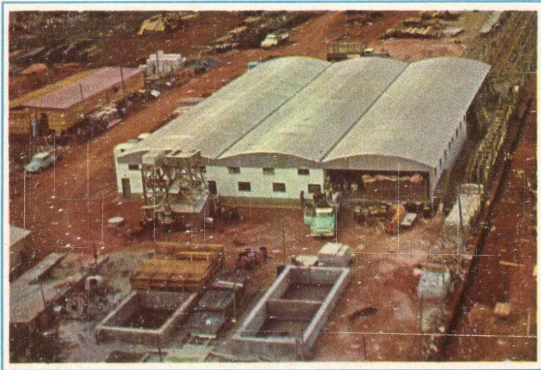
Vista aérea do depósito da "FOL" — Fornecedora de Materiais para construções Ltda. — firma pioneira no gênero, e uma das que mais colaboram na construção de Brasília. Otto Burlier da Silveira, seu titular sente-se orgulhoso dos trabalhos prestados pela "FOL".
